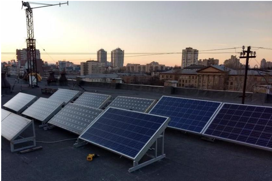
Зображення встановленої СЕС на даху корпусу №22
